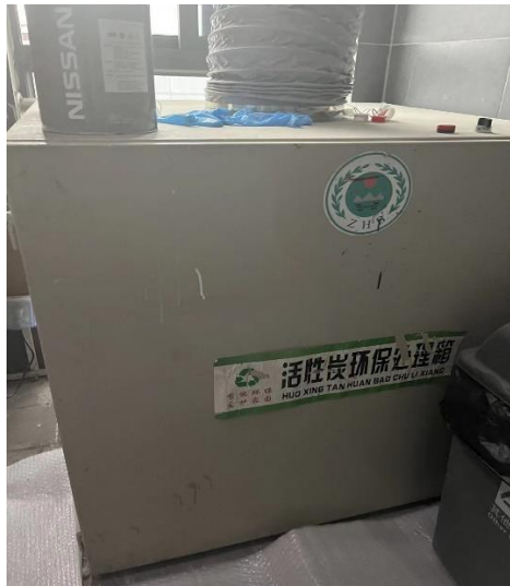
调漆房废气处理设备
