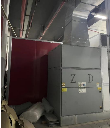
1 号烤漆房废气处理设备
