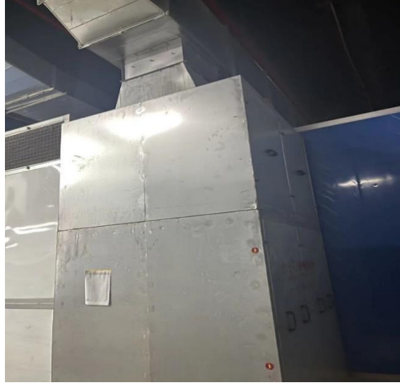
2 号烤漆房废气处理设备
